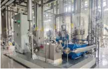
Planta Myande con equipos de procesamiento de aceites con tecnología Nanocavitación. (Foto: Myande, China).
